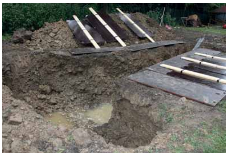
Obrázek 6, Přítomnost vody ve výkopu [5]
